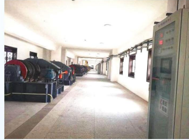
应用于三峡工程重庆开县水位调节坝 2 \times 63\text{T} 直拉式弧门启闭机上
